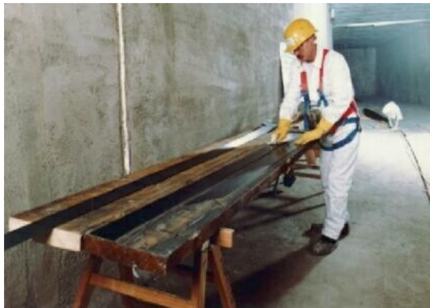
Bild 3: Reinigen der Lamellen im Inneren des RRB
